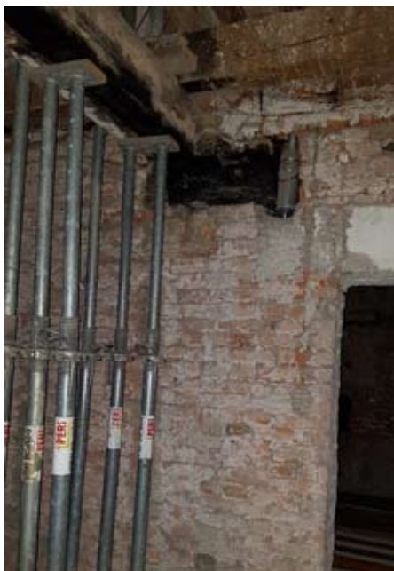
– Havarijní stav nosných železobetonových prvků stropu – železobetonový průvlak provedený z nekvalitního železobetonu zaústěný do komínového tělesa a poškozený ohněm a zplodinami z hoření. –
