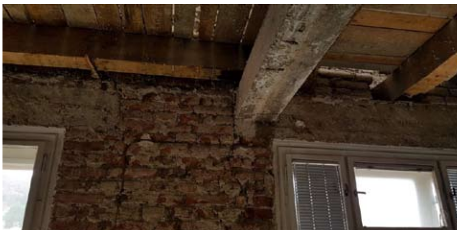
– Chybné uložení železobetonového průvlaku na okraj nosného zdiva obvodové stěny – viditelná svislá trhлина ve zdivu vlivem tohoto chybného uložení. –
