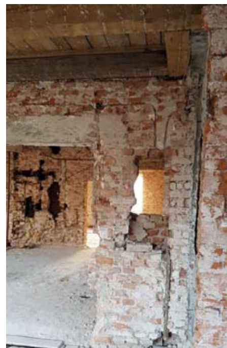
– Dodatečně bourané otvory v nosných stěnách a zejména v extrémně zatížených místech pod uložením průvlaku. –
