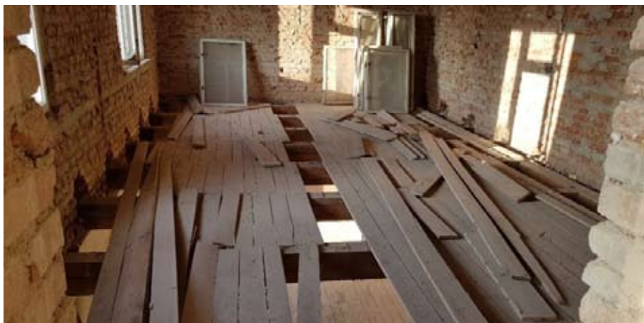
– Základy stropu provedené z nekvalitních a krátkých prken. Tento stav vylučuje realizaci původně navržených úprav nosné stropní konstrukce. –
