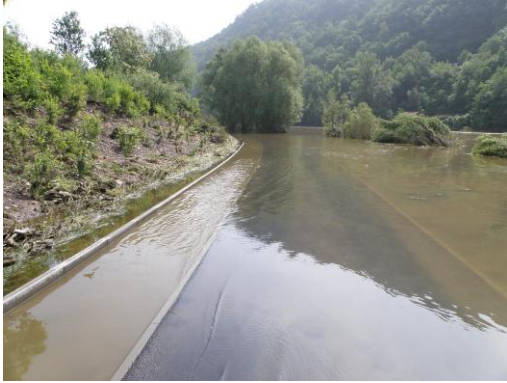
úsek Pod Hladkou Skálou po povodni
